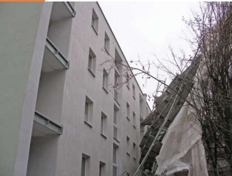
Teilweise umgestürztes Gerüst; unzureichende Verankerung
