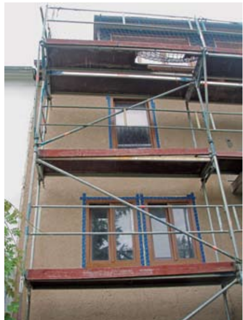
Einen Schwerverletzten auf Grund eines mangelhaften, durchgebrochenen Gerüstbelages forderte ein Absturz aus 6 m Höhe auf dieser Baustelle.
